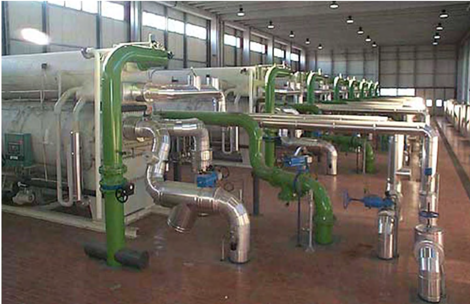
La centrale di Malpensa ( 8 \cdot 4,5 \text{ MW}_f )
