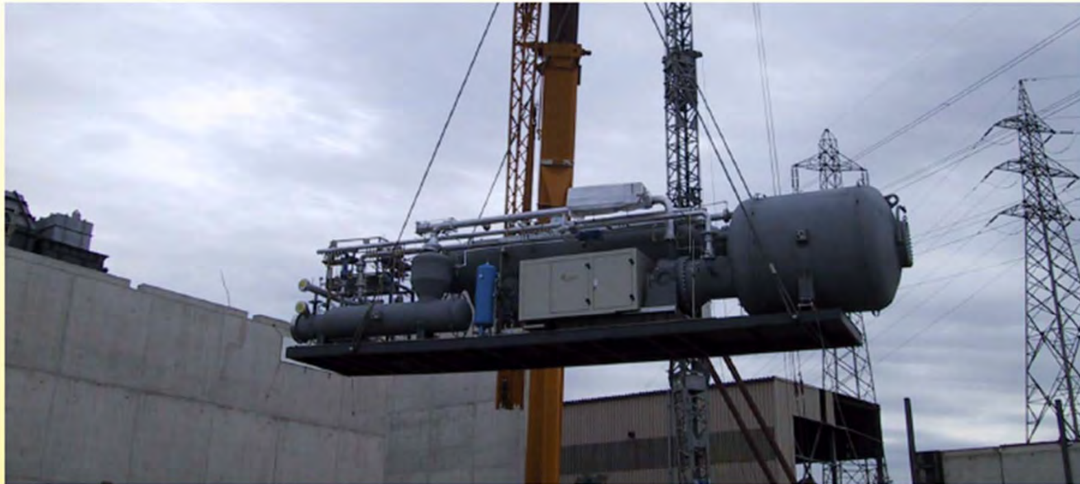
Turboden T600 – CHP (600 kW el )
